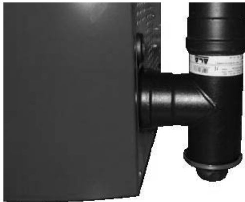
Fig. 55 - Fume conduit cleaning
